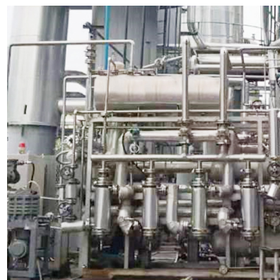
燃料乙醇大型生產設備 產量10,000噸/年
