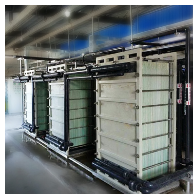
EDR大型濾鹽設備 5000噸/日
